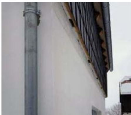
Abb. 20: Spaltenquartiere hinter Schieferverkleidung 9
