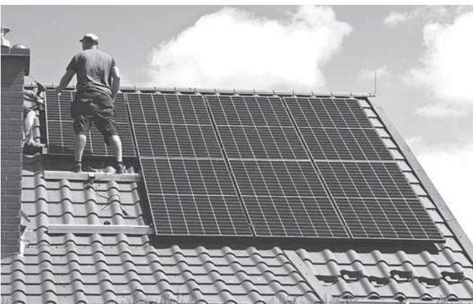
Auch kleine Dachflächen eignen sich für Photovoltaikanlagen Foto: Adobe Stock
